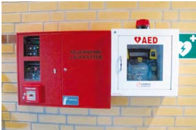
Bild 11-5: Brandmeldezentrale mit Laufkarten
