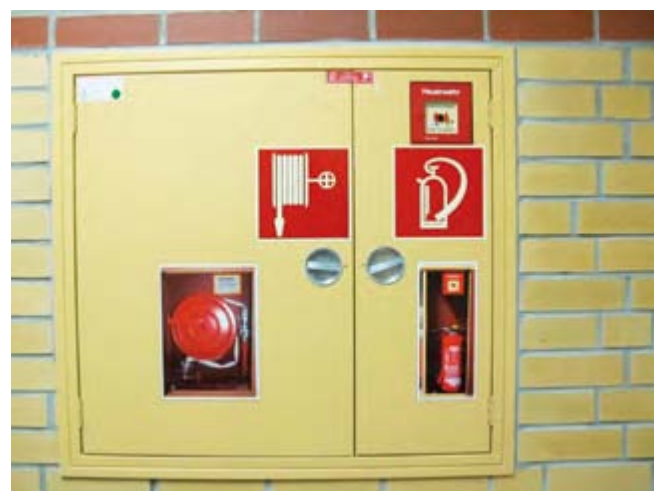
Bild 11-32: Wandhydrantenschrank mit Druckknopfmelder
