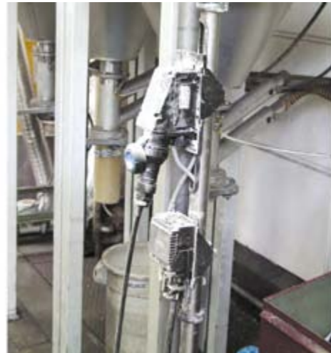
Bild 10-8: Elektrische Steckverbindung in explosionsgefährdetem Bereich
